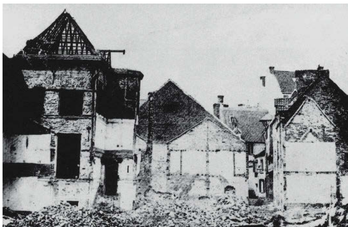
Slopingwerken tijdens de overvelving van de Zenne; rechts: wat er overblijft van de Waterpoortgang.
